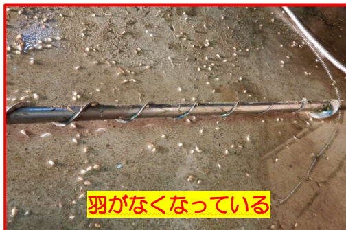
写真2 羽の摩耗状況
