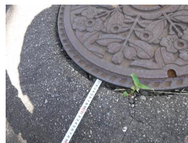
温海浄化センター マンホール周辺の沈下
