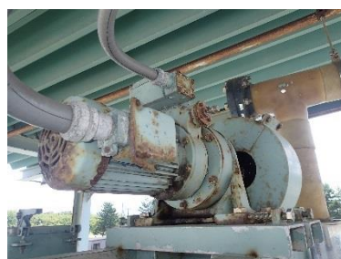
汚泥し渣搬出コンベヤ 発錆・腐食
