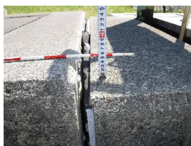
温海浄化センター 地盤沈下
