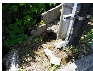
小国 No.5 マンホールポンプ 陥没
