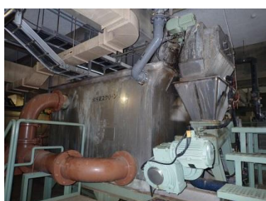
生汚泥スクリーン 腐食
