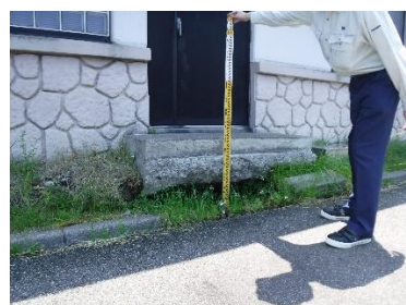
西目地区浄化センター 地盤沈下
