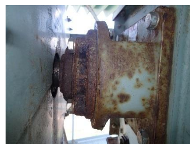
軸受 発錆・腐食
