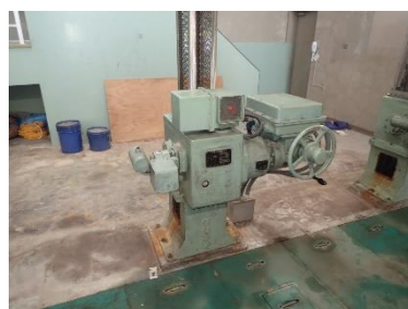
流入ゲート 発錆・腐食
