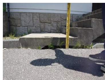
小国地区浄化センター 地盤沈下
