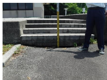
上郷地区浄化センター 地盤沈下
