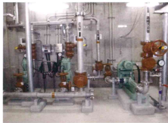
汚泥ポンプ室（汚泥ポンプ・濃縮汚泥ポンプ）
