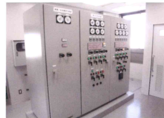
管理室（動力制御盤・買電-仮設電源切替盤）
