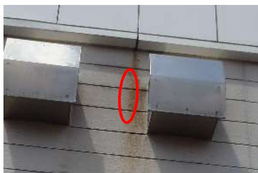
屋根内部からの水漏れ跡
