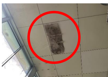
【櫛引】下処理室天井の水漏れ跡
