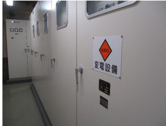
高圧受電設備
