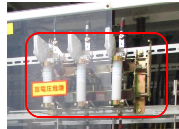
高圧気中負荷開閉器
