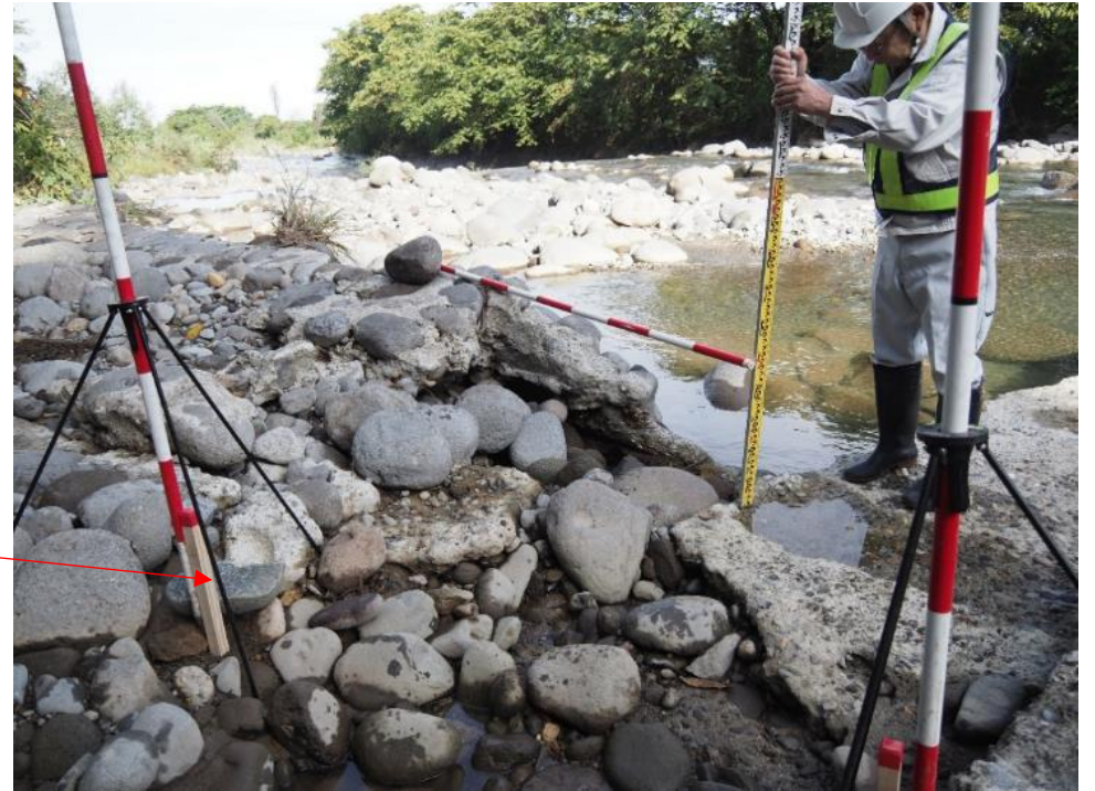
水路(石積)の流出 1.6×1.5×0.3m
