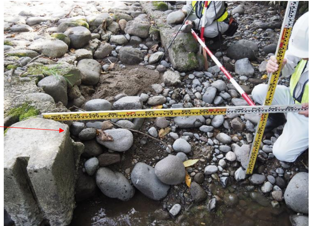
水路(石積)の流出 1.4×1.2×0.5m
