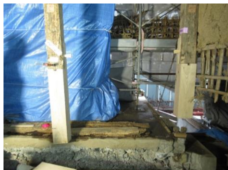
柱の根継ぎ状況。 腐食部分を取り除き、新しい材で継ぎ補修している。
