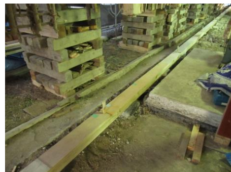
基礎土台の修理状況。 腐食した土台を取り除き、新規材で修繕している。
