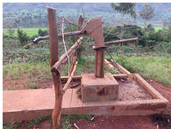
※ 故障後放置された井戸②
