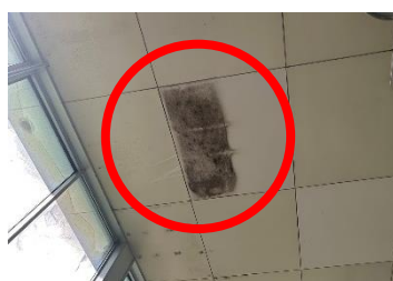
【櫛引】下処理室天井の水漏れ跡
