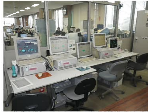
水道施設監視システム
