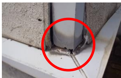
【鶴岡】外壁鉄骨の断裂
