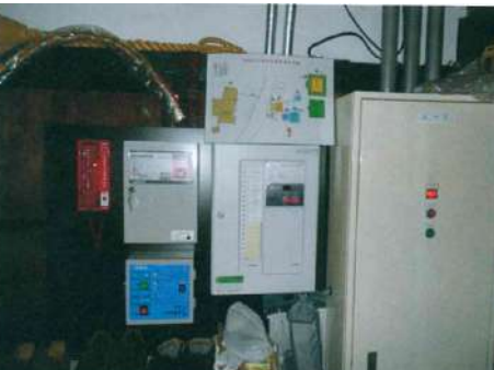
火災報知機受信盤・非常通報装置・ポンプ起動操作盤 各設置状況
