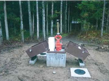
黄金堂背面放水銃 カバーを開けた状
