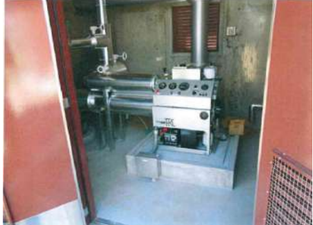
ポンプ室エンジンポンプ設置状況
