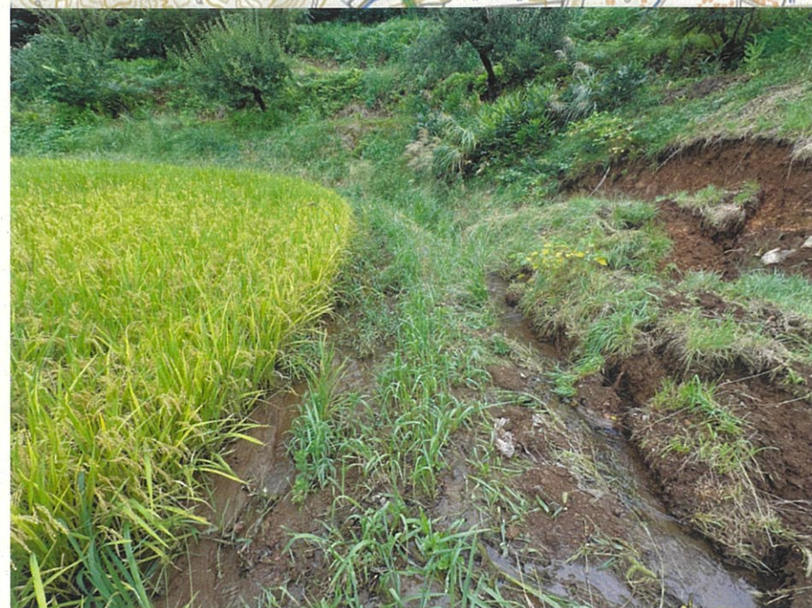
⑥ 水路閉塞（西荒屋）
