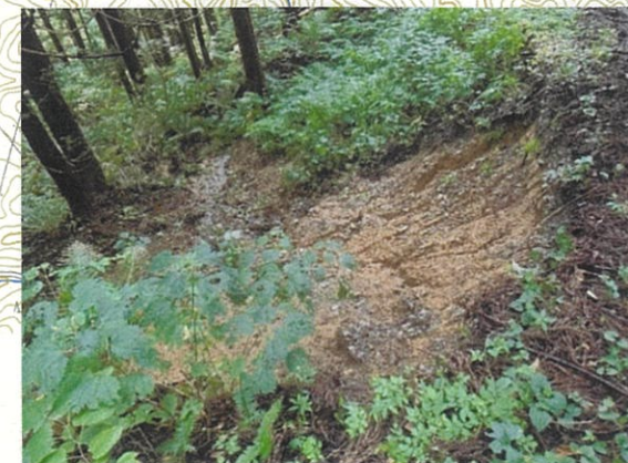
⑥ 路肩欠壊 (松根)
