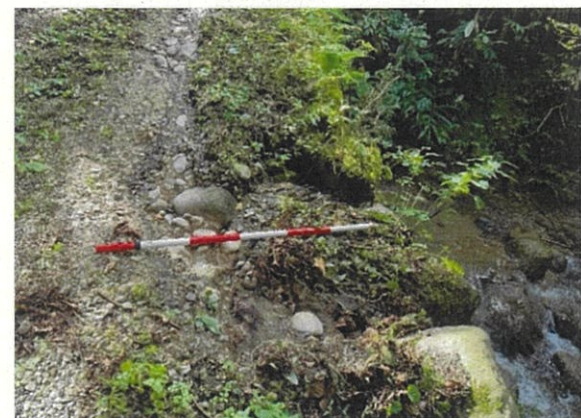
④ 路面洗堀 (西荒屋)
