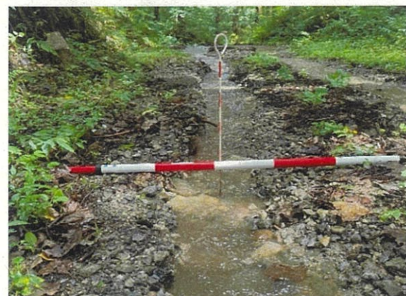
③ 路面洗堀 (西荒屋)
