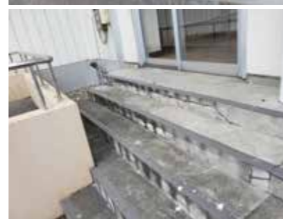
藤島小の躯体の劣化
