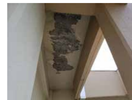
藤島小の軒天材の剥離
