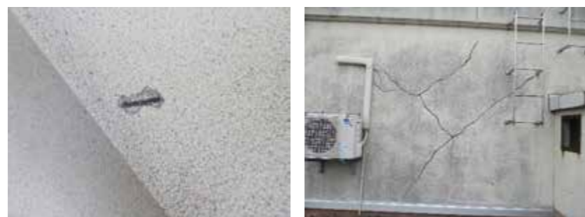
東栄小の躯体の劣化
