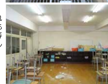
藤島中の化粧モルタルの剥離落下 躯体コンクリートの補修で塗られたモルタルが経年劣化で剥離した（緊急修繕済）
