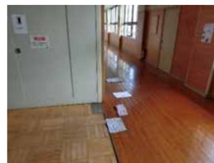
渡前小の雨漏り（3階）
