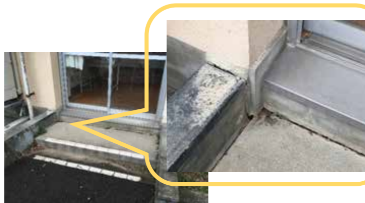
藤島中の校舎（外回り）のゆがみ
