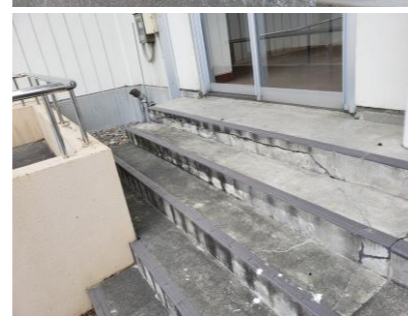
藤島小の躯体の劣化
