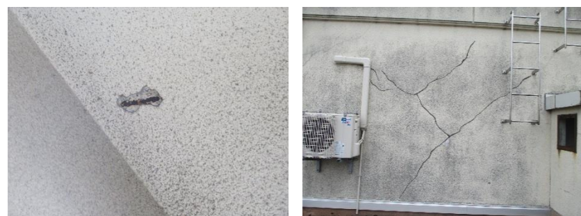
東栄小の躯体の劣化
