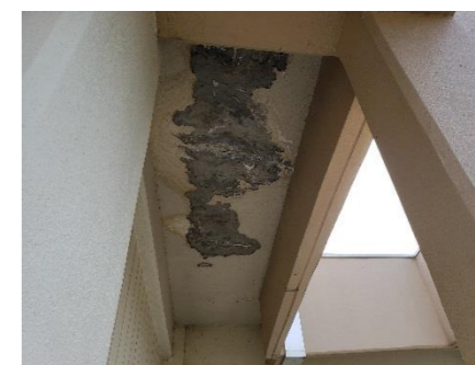
藤島小の軒天材の剥離 上部躯体のひび割れが貫通して雨水が侵入し、仕上げ材が膨れ剥離したもの
