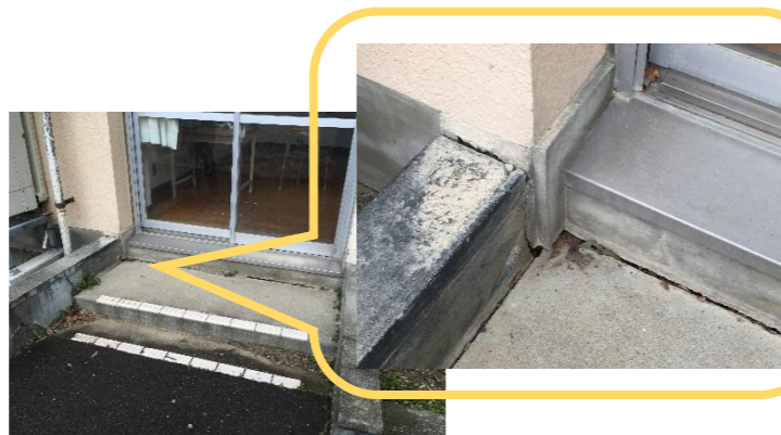
藤島中の校舎（外回り）のゆがみ
