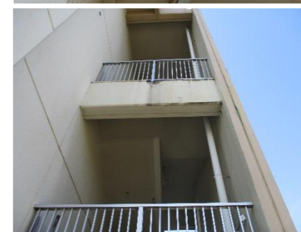
藤島小の外部階段手摺 劣化しているため手摺を更新したいが躯体強度が無いため更新できない。
