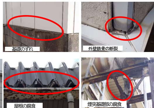
現鶴岡センターの老朽化の状況
