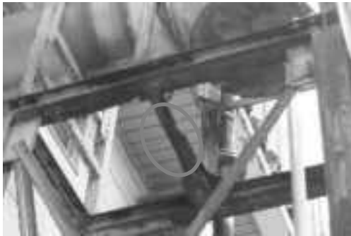
煙突基礎部の腐食
