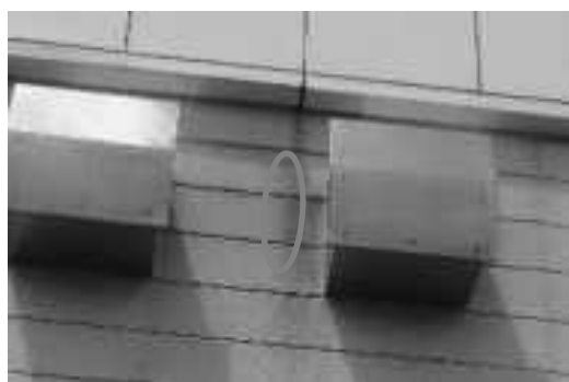
屋根内部からの水漏れ跡
