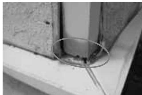
外壁鉄骨の断裂
