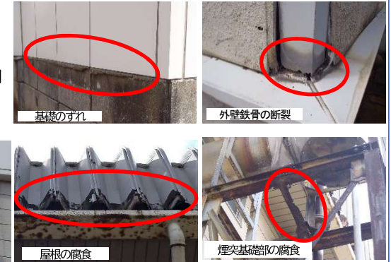
現鶴岡センターの老朽化の状況
