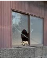
窓が割れた管理不全空家
