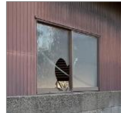
窓が割れた管理不全空家
