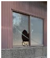
窓が割れた 管理不全空家
