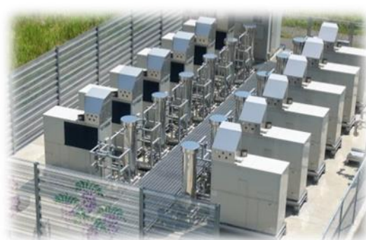
消化ガス発電施設（鶴岡バイオガスパワー）
