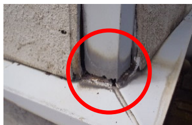
【鶴岡】外壁鉄骨の断裂
