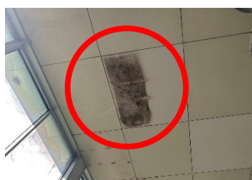
【櫛引】下処理室天井の水漏れ跡
