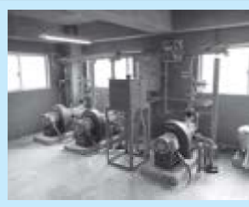
大針ポンプ場内の様子
