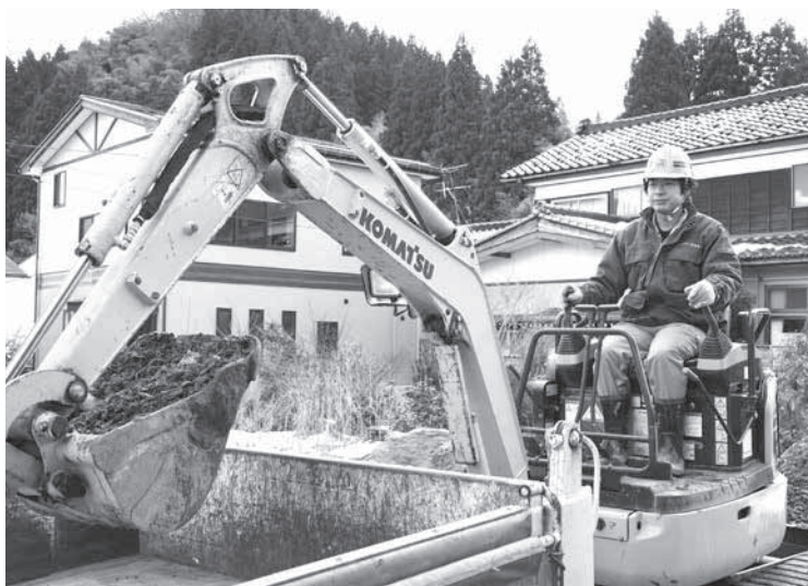
▲ふだんは主に管工設備を施工する会社で仕事をしています
