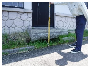
西目地区浄化センター 地盤沈下
