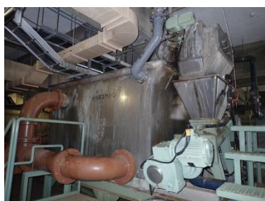
生汚泥スクリーン 腐食
