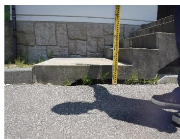
小国地区浄化センター 地盤沈下
