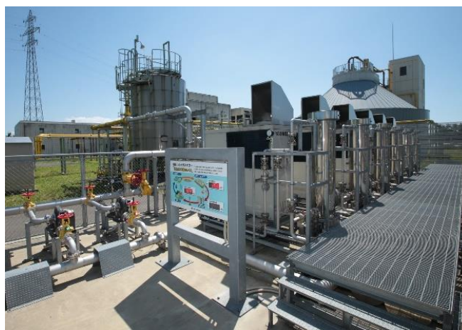
図 2-19 鶴岡バイオガスパワー
