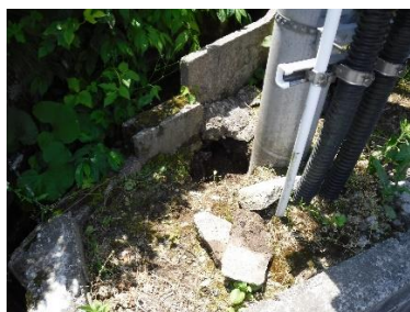
小国 No.5 マンホールポンプ 陥没
