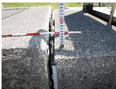
温海浄化センター 地盤沈下
