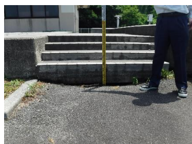
上郷地区浄化センター 地盤沈下
