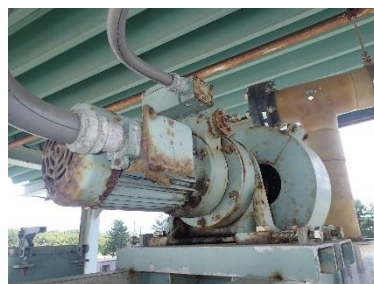
汚泥し渣搬出コンベヤ 発錆・腐食
