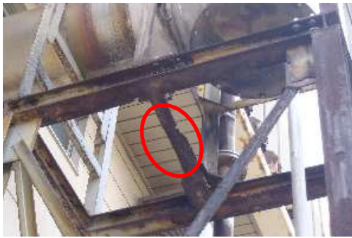
煙突基礎部の腐食
