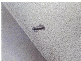
東栄小の躯体の劣化
