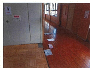
渡前小の雨漏り （3階）
