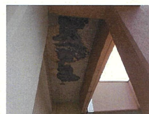
藤島小の軒天材の 剥離 上部躯体のひび割 れが貫通して雨水 が浸入し、仕上げ 材が膨れ剥離した もの
