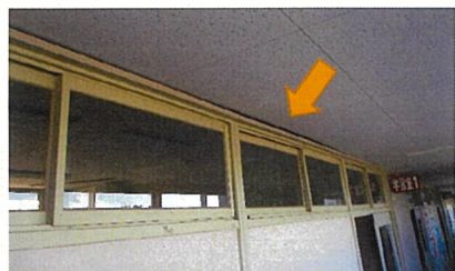
藤島小の校舎内のゆがみ
