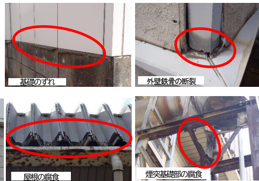
現鶴岡センターの老朽化の状況
