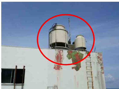
屋上 落下の危険がある給水塔
