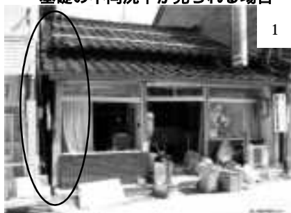
柱の傾斜（ 1/60 \sim 1/20 ）
