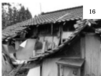
構造部材の大規模な損傷
