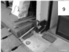
基礎の部分的な欠損
