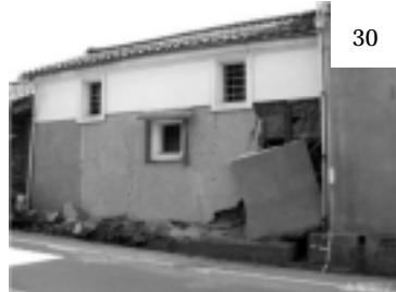
30 大規模なひび割れ及び剥落
