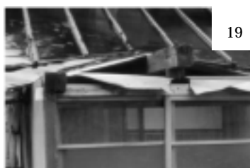
構造部材の大規模な損傷
