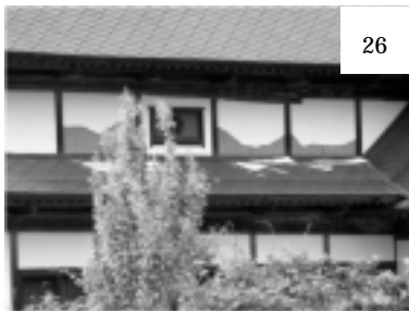
26 外壁仕上げの一部が剥落
