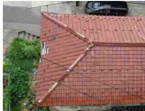
屋根の一部落下
