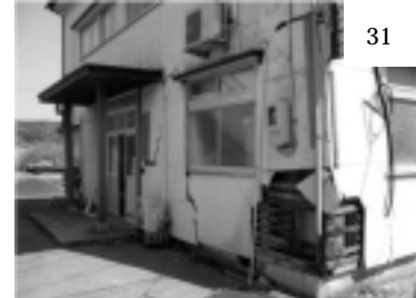
31 著しいひび割れ
