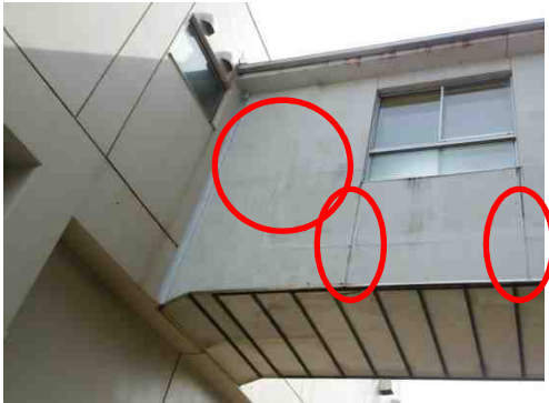
渡り廊下の壁面に膨らみとひび
