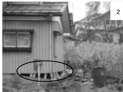
局所的な基礎の不同沈下
