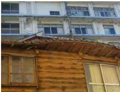
屋根を支える梁が折れ屋根が陥没
