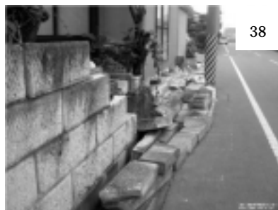
既に倒壊している (25点)
