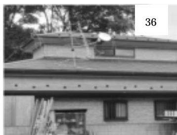
テレビアンテナの落下のおそれ
