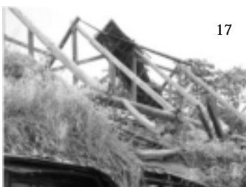
構造部材の大規模な損傷
