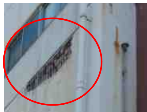
壁の爆裂現象による剥離・落下(複数箇所)
