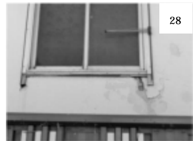
28 外壁にひび割れと剥離
