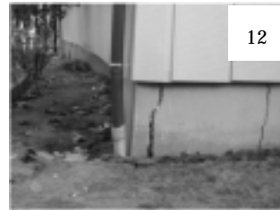
基礎の著しいひび割れ
