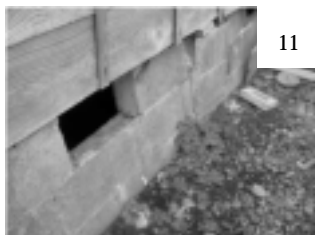
基礎に著しい損傷と傾斜
