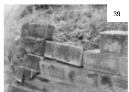
既に倒壊している (25点)
