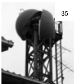
屋上の高架水槽に落下のおそれ
