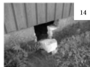
基礎に大規模な欠損
