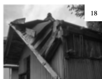
構造部材の大規模な損傷
