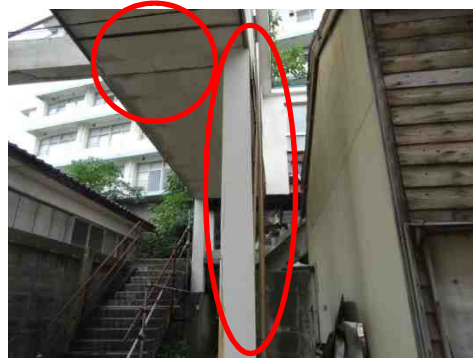
柱に膨らみ（応急処置済） （床材の落下の危険性あり）
