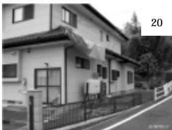
屋根ふき材の剥離
