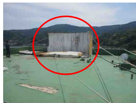
ベランダに崩れ落ちた水槽 (ロープで仮固定)
