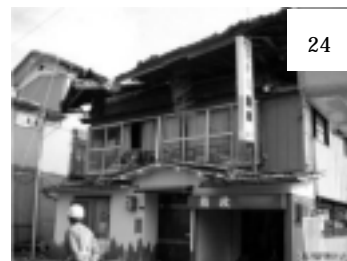
屋根が著しく破損している
