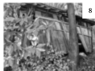
一見して倒壊のおそれがある
