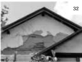
32 著しい劣化による壁下地の露出
