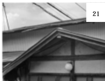
屋根ふき材の剥離
