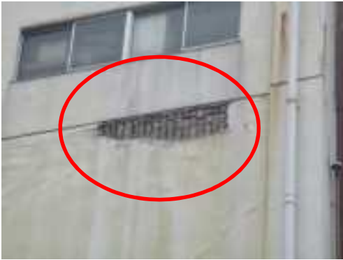
(2) - ロ 外壁の著しい破損
