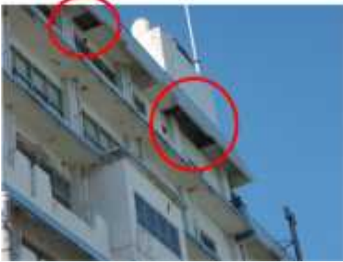
(2) - (イ) 軒裏材の破損
