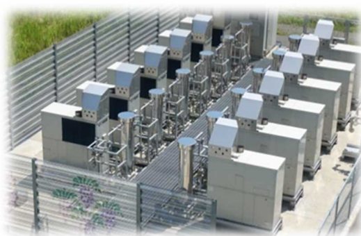
鶴岡バイオガスパワー(消化ガス発電)
