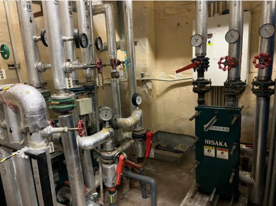
機械室(熱交換器)
