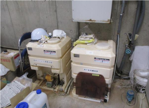
除鉄室(薬注装置)
