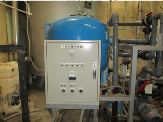
機械室(かたくりの湯浴槽ろ過装置)
