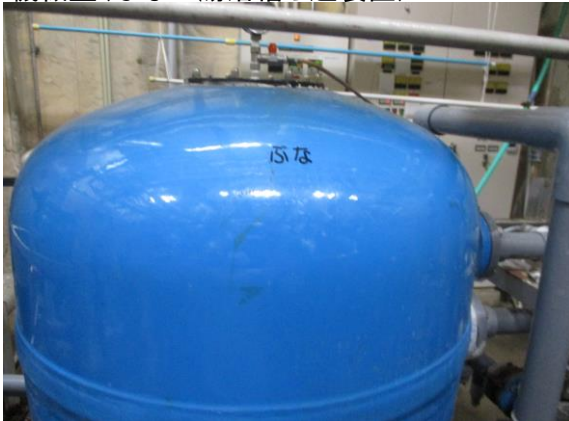
機械室(ぶなの湯浴槽ろ過装置)
