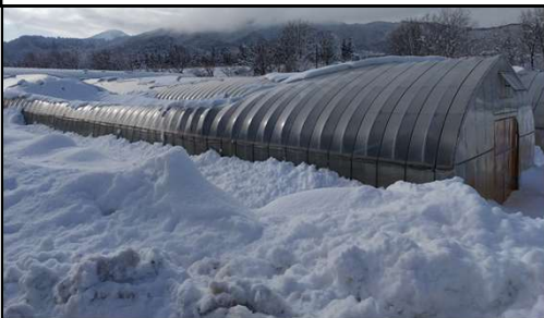
パイプハウスの倒壊 (高坂地内)
