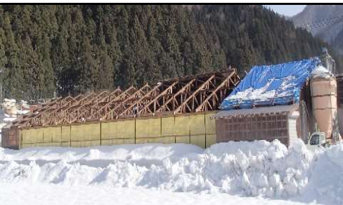
豚舎の屋根飛散 (小名部地内)
